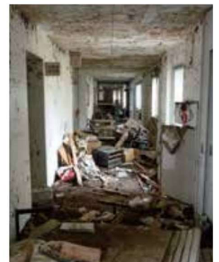
宮城県東松島市 小学校の被害の様子 出典：(一財)消防防災科学センター「災害写真データベース」
